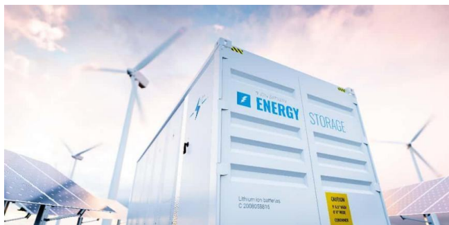
2. 储能系统（BMS 供电）
